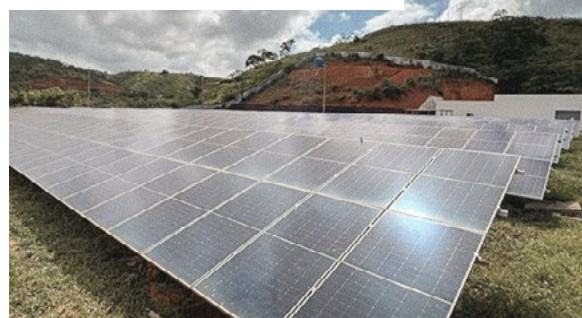
▾ Sistemas de placas solares no Unihealth Hospital Três Vales
